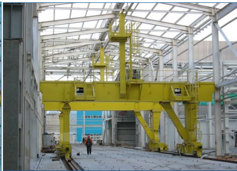
Трансбордер грузоподъемностью 200 т пролетом 20 м Хакасский алюминиевый завод
